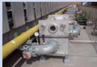
丸型光触媒浄水機(三井別館クーリングタワー用)
