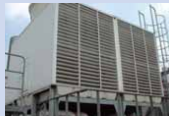
クーリングタワー(三井別館)
