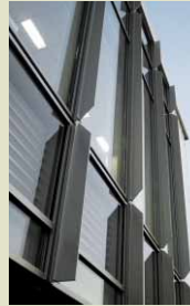
日射遮蔽効果のある垂直フィン付きカーテンウォール
