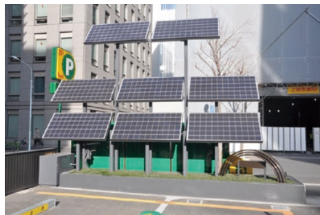
場内に設置した太陽光パネル
