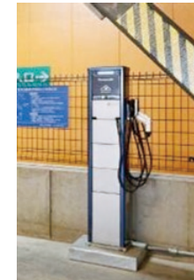
「ダイバーシティ東京 プラザ」の 電気自動車充電スタンド
