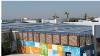
屋上に設置した約600kWの太陽光発電設備
