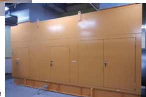
非常用発電機
