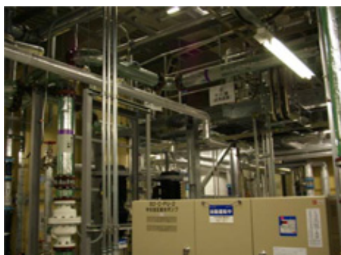
防災用飲料井戸ろ過設備
