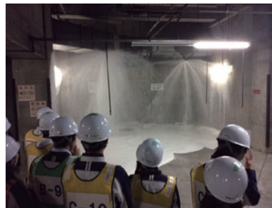
泡消火設備放出訓練
