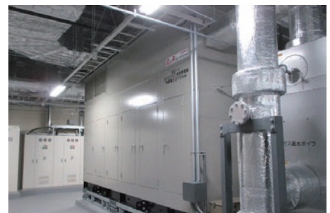
「ららぽーと湘南平塚」のコジェネレーションシステム
