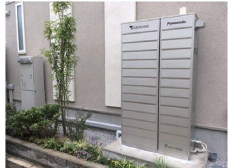
「ファインコート」に設置した「エネファーム」
