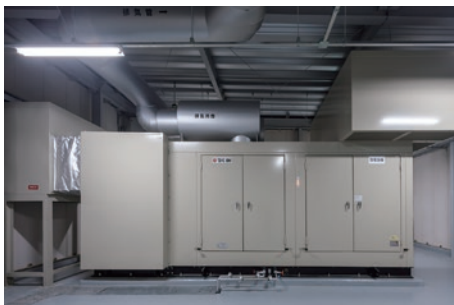
MFLP船橋Iの非常用発電機
