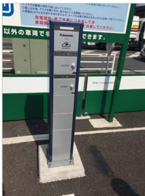
「『三井のリパーク』変なホテル舞浜 東京ベイ駐車場」（千葉県浦安市）のEV・PHV用充電器
