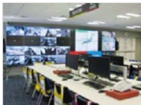
災害対策本部室（三井二号館）
