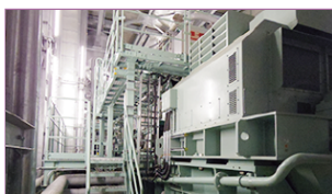
▶ 「ガスコジェネレーション」
