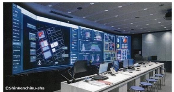
エリアエネルギー管理を担う中央監視室
