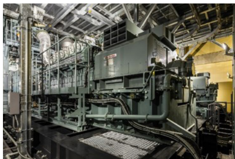
大型のガスコジェネレーションシステム
