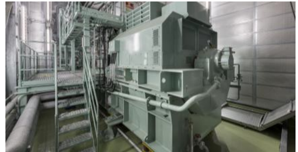
コジェネレーションシステム
