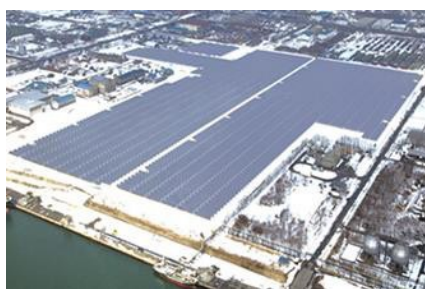
苫小牧太陽光発電所
