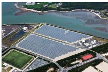
山陽小野田太陽光発電所
