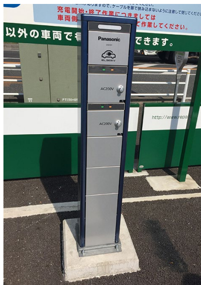
「三井のリパーク」変なホテル舞浜 東京ベイ駐車場(千葉県浦安市)のEV・PHV用充電器
