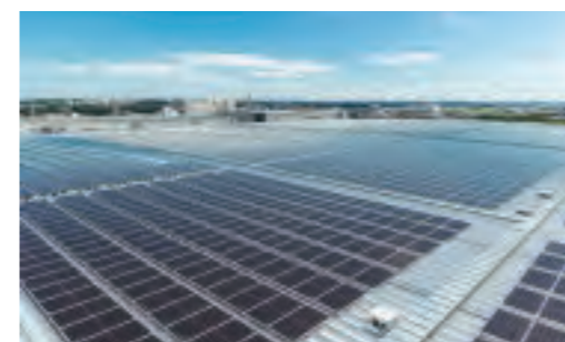
屋上に設置された太陽光パネル
