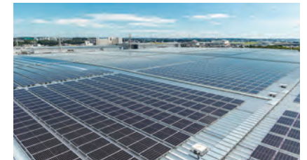
屋上に設置された太陽光パネル
